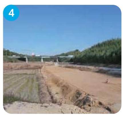
石ヶ谷JCT付近 付加車線事業の工事で必要となる工事用道路の工事を実施しています。
