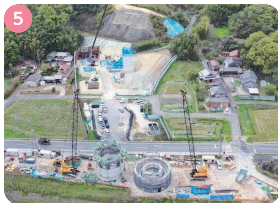
5 石ヶ谷JCT付近 明石川右岸側では橋脚の基礎及び構築工事を行っています。
