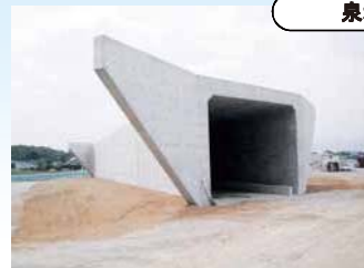
カルバートボックスの施工を行っています。基礎杭の施工を行っています。
