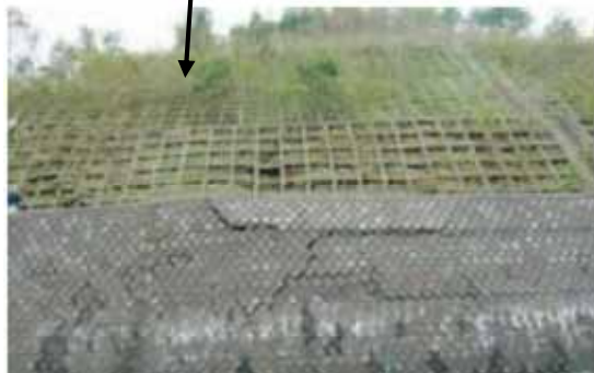
▲のり面災害状況
