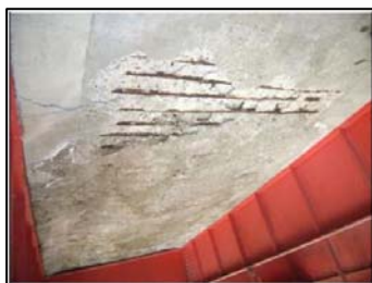
コンクリートの剥離、鉄筋腐食
