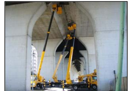
《コンクリート片剥落対策》
