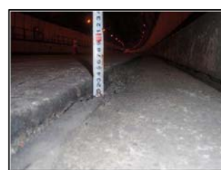
路面隆起による段差
