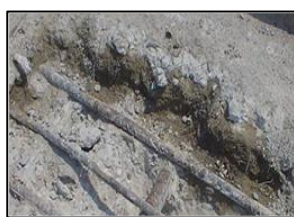
コンクリートの土砂化
