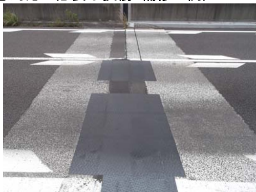
《伸縮装置の損傷(補修前)》
