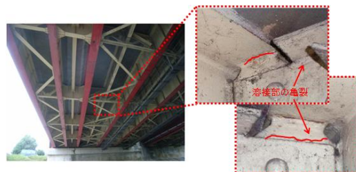
桁下面の変状
