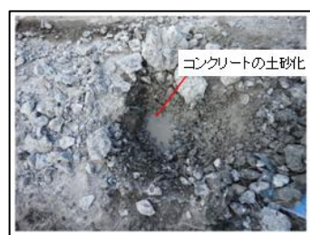
コンクリートの土砂化
