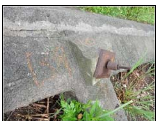
アンカー定着部の浮き
