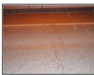
路面隆起によるクラック
