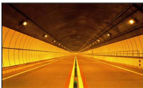
《従前のナトリウム照明》
