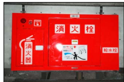
《更新後の消火栓》
