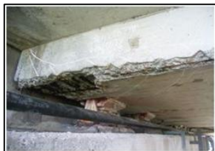
コンクリートの剥離、鉄筋腐食
