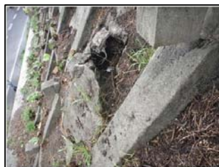
グラウンドアンカーの機能低下による切土のり面の変状
