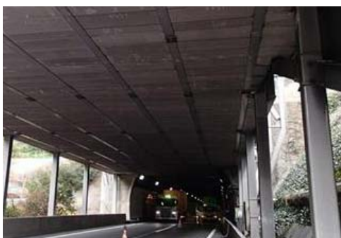
《天井板(長峰)対策前》
