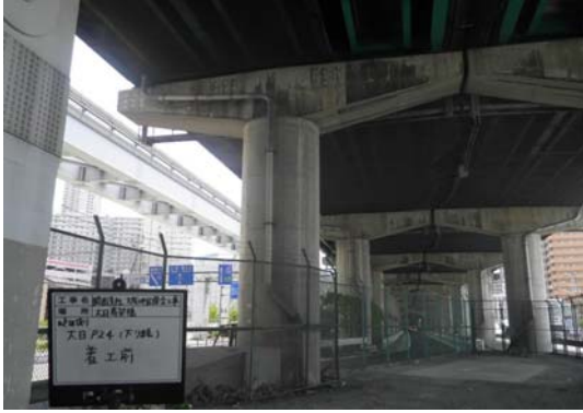
《橋梁下部工はく落対策(補修前)》
