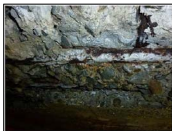
コンクリートの剥離、鉄筋腐食
