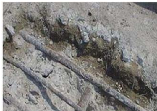
《床版上面のコンクリート土砂化》
