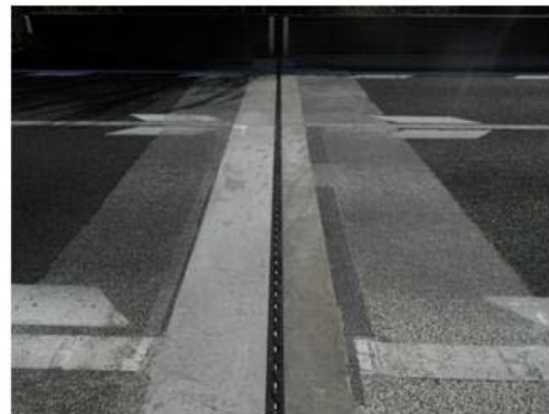
《伸縮装置の損傷(補修後)》
