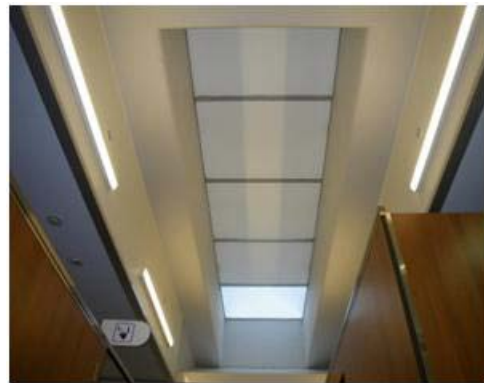
《トイレ照明のLED化》
