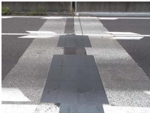
《伸縮装置の損傷(補修前)》
