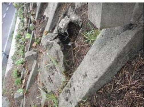
《グラウンドアンカーの機能低下によるのり面変状》
