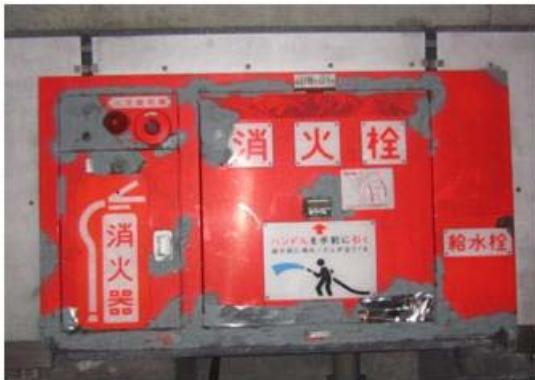
《従前の消火栓》
