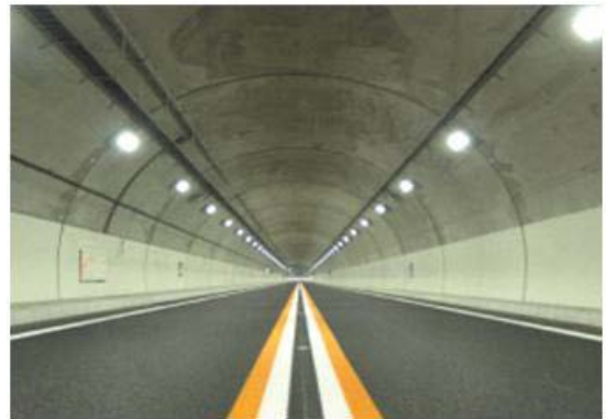
《更新後のLED照明》
