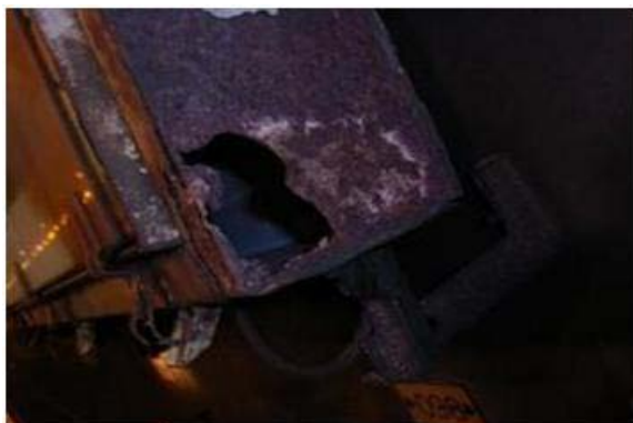
《トンネル照明の緊急補修(補修前)》
