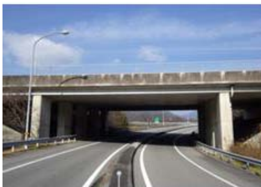
《橋梁上部工はく落対策(補修前)》
