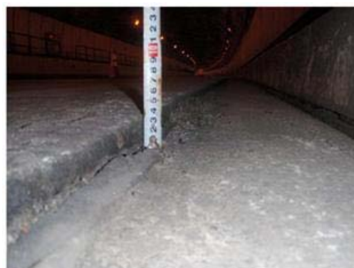
《トンネル路面隆起による段差》
