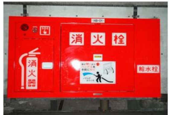
《更新後の消火栓》
