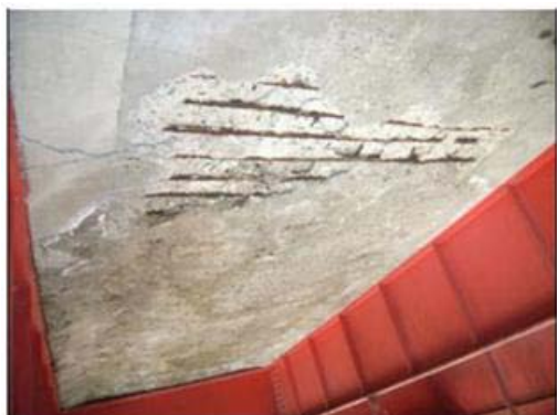
《床版下面のコンクリート剥離・鉄筋腐食》
