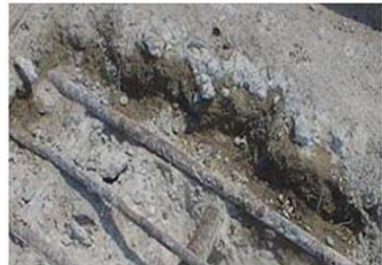
《床版上面のコンクリート土砂化》
