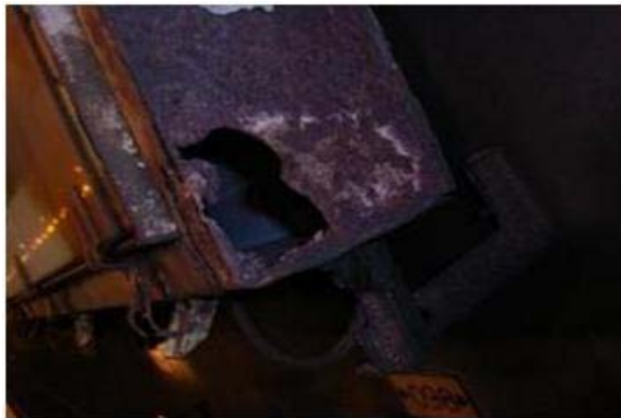
《トンネル照明の緊急補修(補修前)》
