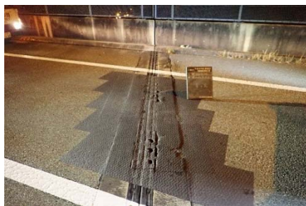
《伸縮装置の損傷(補修前)》
