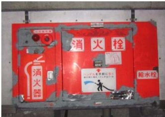
《従前の消火栓》
