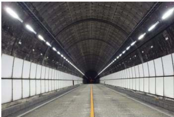
《トンネル照明のLED化》
