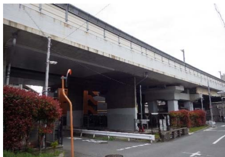
《橋梁上部工はく落対策(補修前)》
