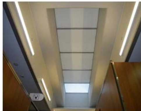
《トイレ照明のLED化》
