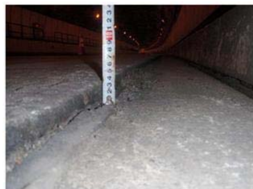
《トンネル路面隆起による段差》
