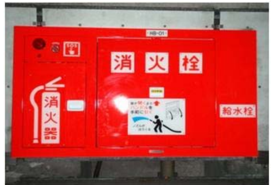
《更新後の消火栓》
