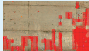
AutoCIMAシステムのUAV活用による変状自動判別着色の濃淡で損傷程度を表示
