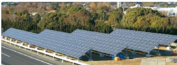
【太陽光発電などの設置】
