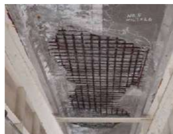
下面 コンクリートの剥離
