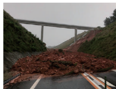
切土のり面崩落/東九州道(椎田南IC～豊前IC)
