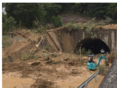
流木・土砂等の流入/山陽道（本郷IC～河内IC）
