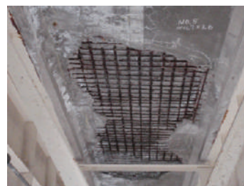
下面 コンクリートの剥離
