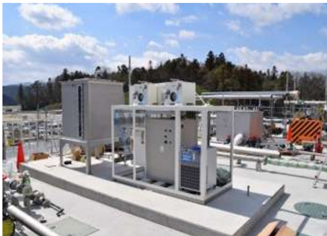
浄化槽汚泥減容化ユニット
