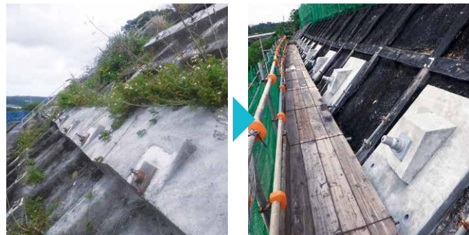
損傷しているアンカー
