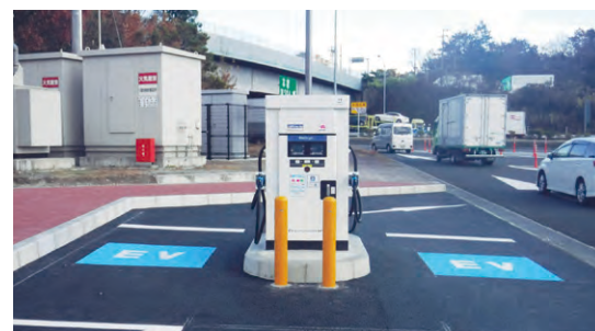
名神高速道路 草津PAの急速充電システム
