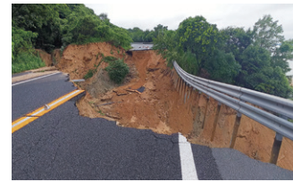
2018年西日本豪雨による広島呉道路
