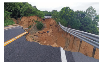
2018年西日本豪雨による広島県道路
