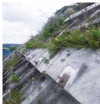
損傷しているアンカー
