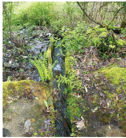
修繕前の縦溝
