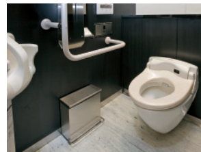
洗浄器付洋式トイレ
