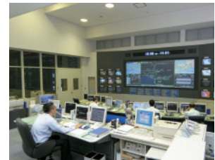
道路管制センター（施設制御部門）
