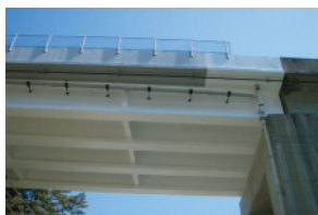
国道と交わる重要交差箇所繊維シートを貼付しています
