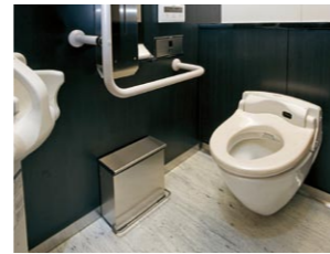
洗浄器付洋式トイレ
