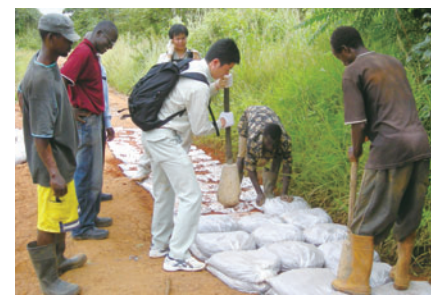
土のうで道路を簡易舗装するNPO法人「道普請人」の活動(ザンビア)
