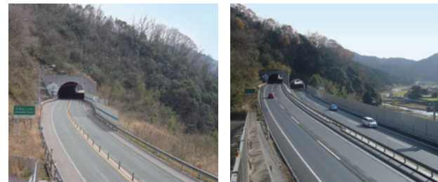
四車線化工事が完了した米子自動車道・久世～上野PA間(左:施工前、右:完成後)
