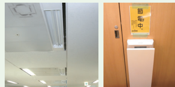
照明の間引きによる節電
