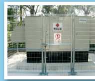
1 自家発電設備を備えたSA・PAを防災拠点に
