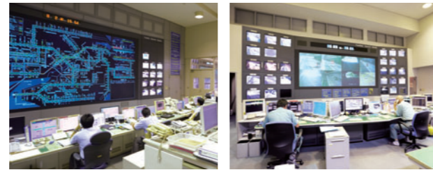
道路管制センター(交通管制部門)
