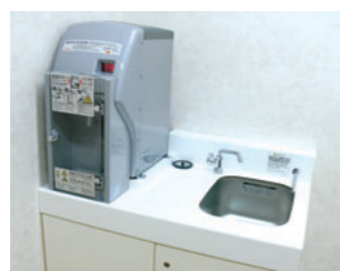
調乳用温水器の設置
