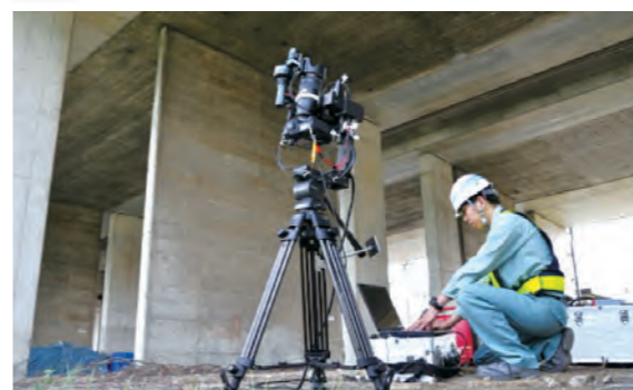
これまでの目視・打音点検に加えて、デジタルカメラでコンクリート表面を撮影し、ひび割れ等の変状を客観的に把握する技術を取り入れています
