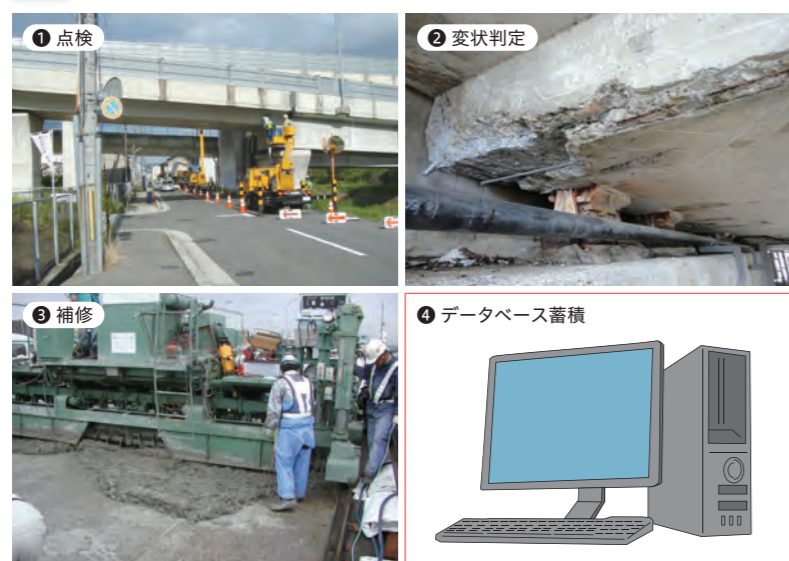
点検から補修までのサイクルを定め、高速道路の保全を計画的に実施しています
