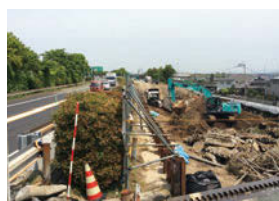
対面交通で復旧した崩落箇所
