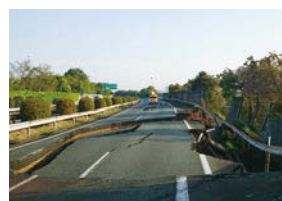
被災直後の崩落箇所
