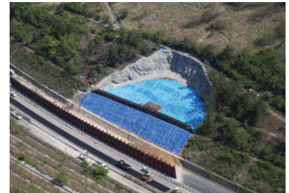
大分道 切土のり面崩落箇所
