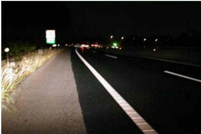
高輝度（凹凸）レーンマーク
