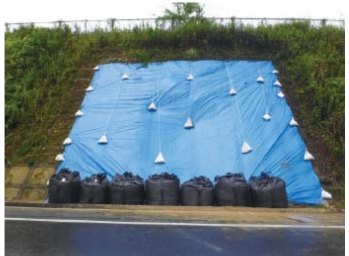
のり面崩壊状況（応急復旧後）
