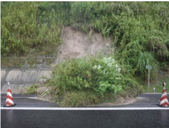
のり面崩壊状況（発災時）
