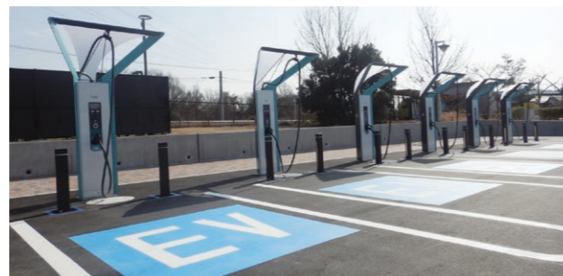
急速充電設備
