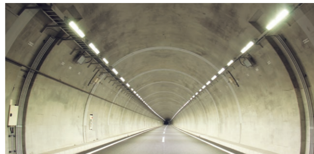
トンネルLED灯
