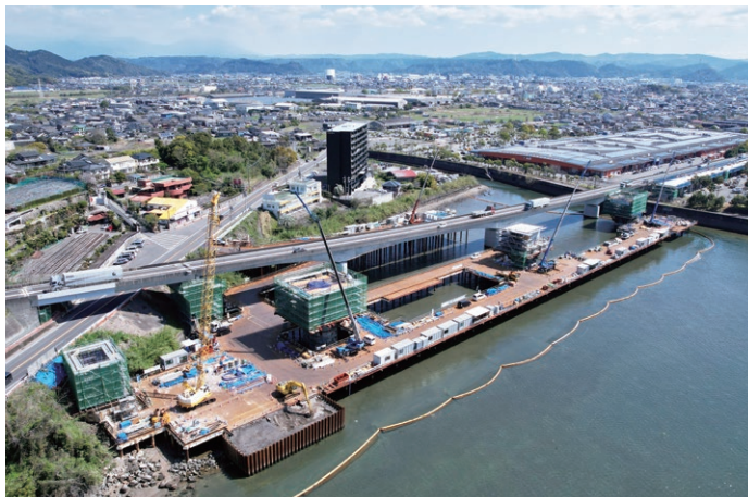
東九州道(隼人道路) 隼人東IC～隼人西IC 清水川橋下部工工事
