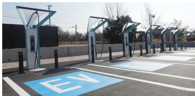
急速充電設備
