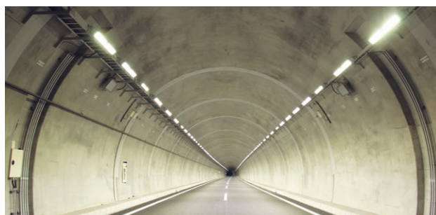
トンネルLED灯
