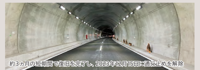
約3ヵ月の短期間で復旧を完了し、2023年12月15日に通行止めを解除
