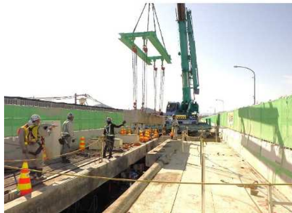
阪和自動車道 松島高架橋 （大規模更新／高速道路の長期保全）
