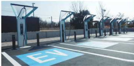
EV急速充電設備
