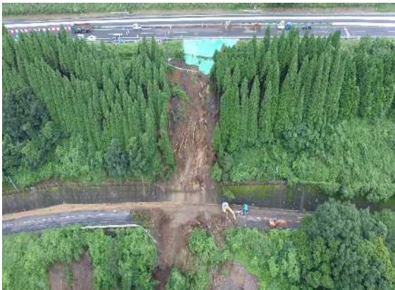
大分道 九重IC～湯布院IC （盛土のり面の崩落／高速道路の災害復旧）
