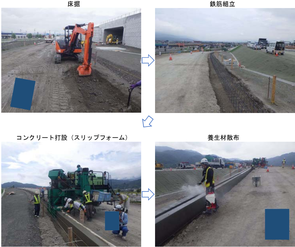
成型機は、コンクリートを供給する搬送装置、鋼製型枠及び締め装置から構成される。
